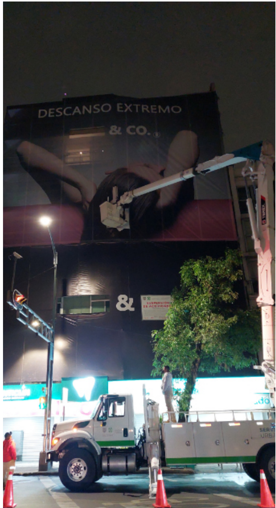
Colocación de sellos de publicidad exterior ilegal envolvente sobre fachadas.
