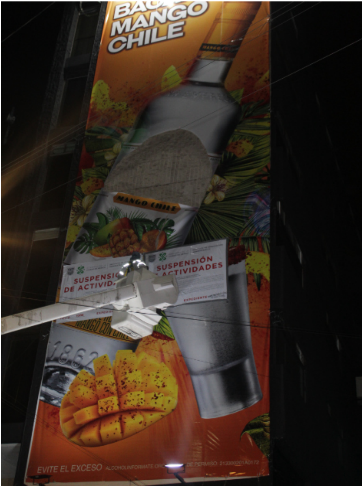
Colocación de sellos de publicidad exterior ilegal envoltorio sobre fachadas.
